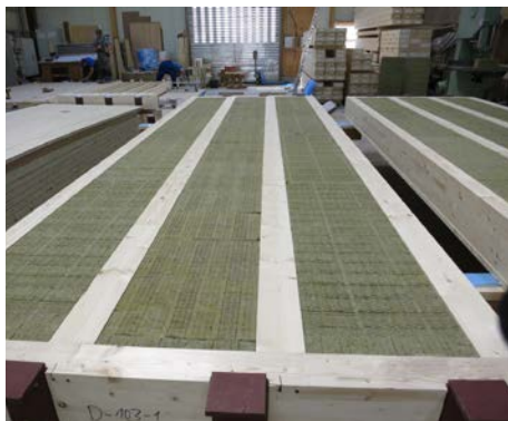
Die Hohlkastenelemente erhielten eine Dämmung aus Mineralwolle. Die Z-förmigen Stahlprofile an der Kopfseite dienen dazu, vertikale Lasten in die Unterzüge abzuleiten
